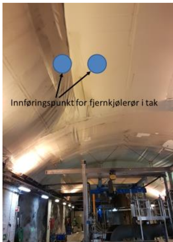
Figur 14 innføringspunkt for fjernkjølerør i tak nær kloakkpumper
