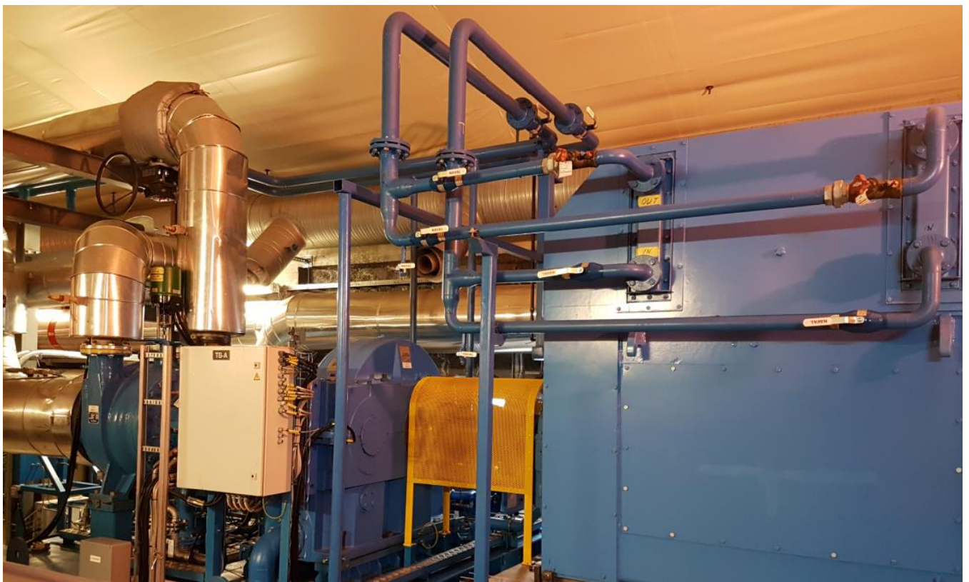
Figur 7 Kompressor, planetgir og vannkjølt høyspentmotor for varmepumpe 1. Gass fra fordampner entrer kompressor horisontalt fra venstre. Gass fra mellomtrykksbeholder entrer kompressor vertikalt, lengst til venstre. Kompressoren leverer høytrykks-gass vertikalt opp og til venstre til kondensator som er installert utenfor bilde.
